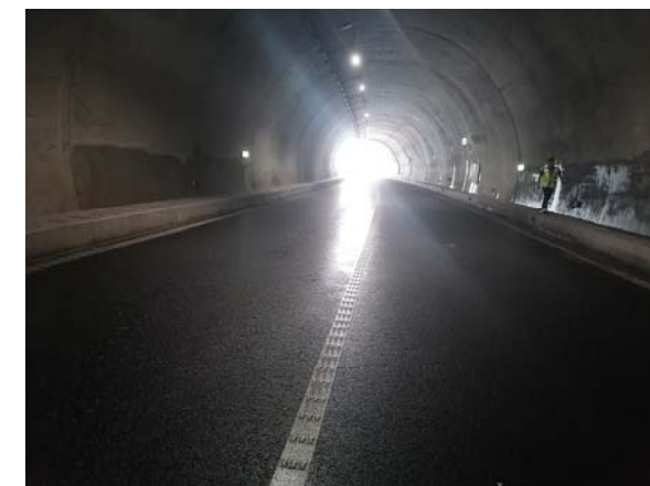
沽洋隧道 AK72+460 路面渗水
